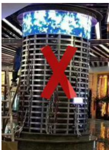
禁止镀锌方管结构安装
