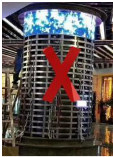
禁止镀锌方管结构安装
